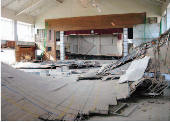
初めて被災地に立った時は、声も出さず、身震いしました。校舎2階の青い看板のところまで、海水に浸かったそうです[写真左]。(岡田)
