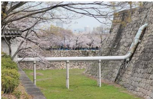
図4 空堀に設置された排水管
